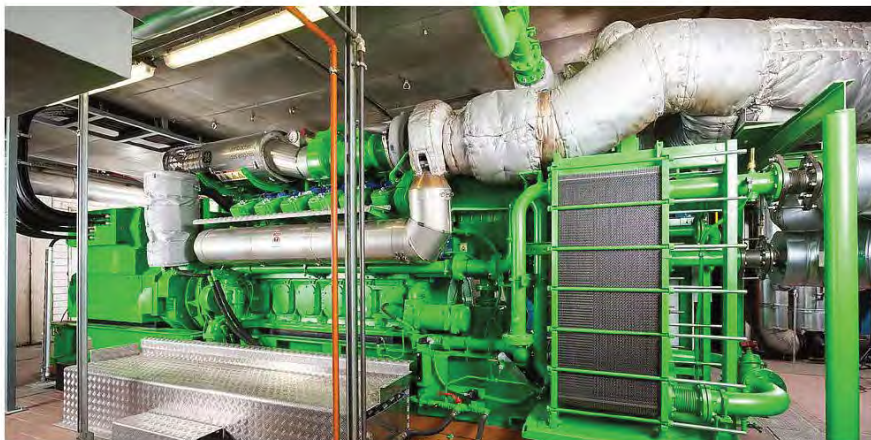
Die Wärmeversorgung in Schwäbisch Hall wird über vier Blockheizkraftwerke sichergestellt, die in Kraft-Wärme-Kopplung betrieben werden. Das Bild zeigt den Motor des Heizkraftwerks Teurershof.
